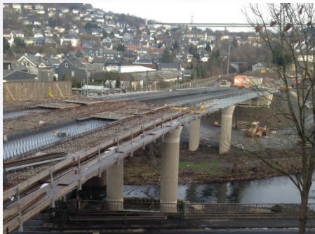
Besuch der HTS-Baustelle in Niederschelden: Das 80 Mio. Euro Projekt liegt im Plan was Kosten und Zeitplan angeht.
